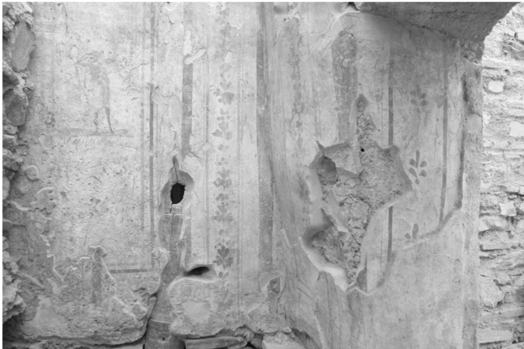
Abb. 14: N-Mauer und nördliche Türleibung von SR 29 mit Rohrleitung und zwei Malschichten
