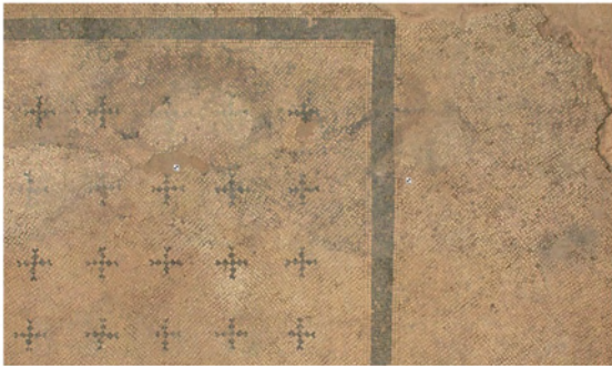
Abb. 40: Mosaik SR 28. Detail Brandschaden im nördlichen Musterfeld
