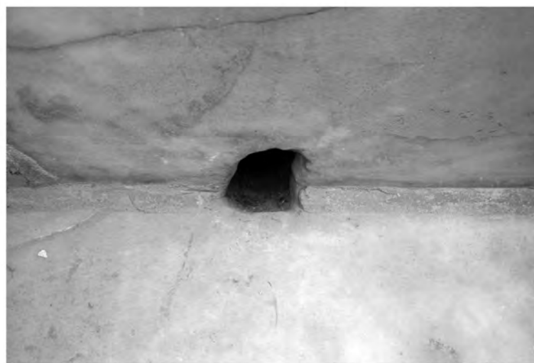
Abb. 35: Marmorsaal 31, Bodenwasserbecken WB-A4, Wasserabfluss
