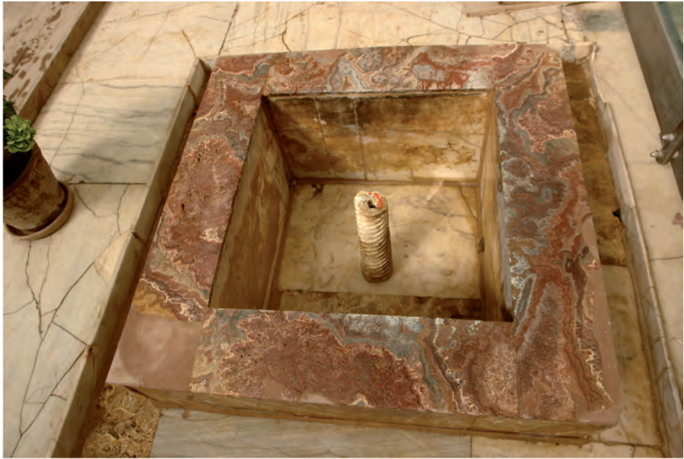
Abb. 6: Marmorsaal 31, Bodenwasserbecken WB-A4 mit Beckenständer
