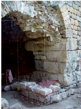
2 Nordansicht. Stark beraubter Zugang zu Raum F während der Sicherung
