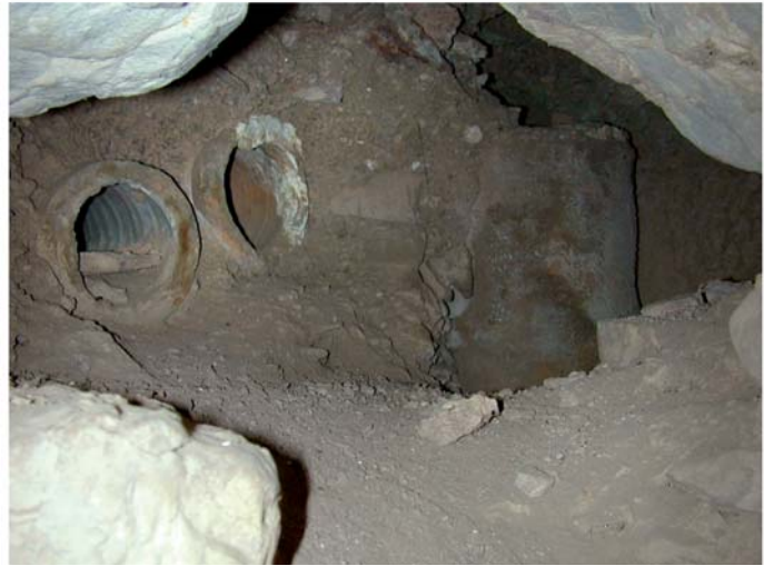
2 Zentralraum V. Korridor in den nördlichen Wirtschaftshof XII. Leitungen vor dem Freispiegelbecken im Obergeschoss
