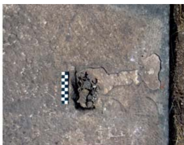
5 Marmorsaal. Sprengung der Basis A 89 durch Korrosionsdruck des Dübels
