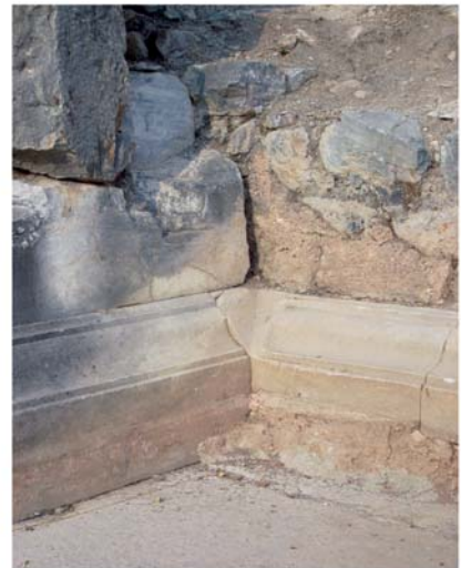
4 Marmorsaal. Detailaufnahme der südlichen Ecke der Hauptnische mit unfertiger Innenecke des Profils
