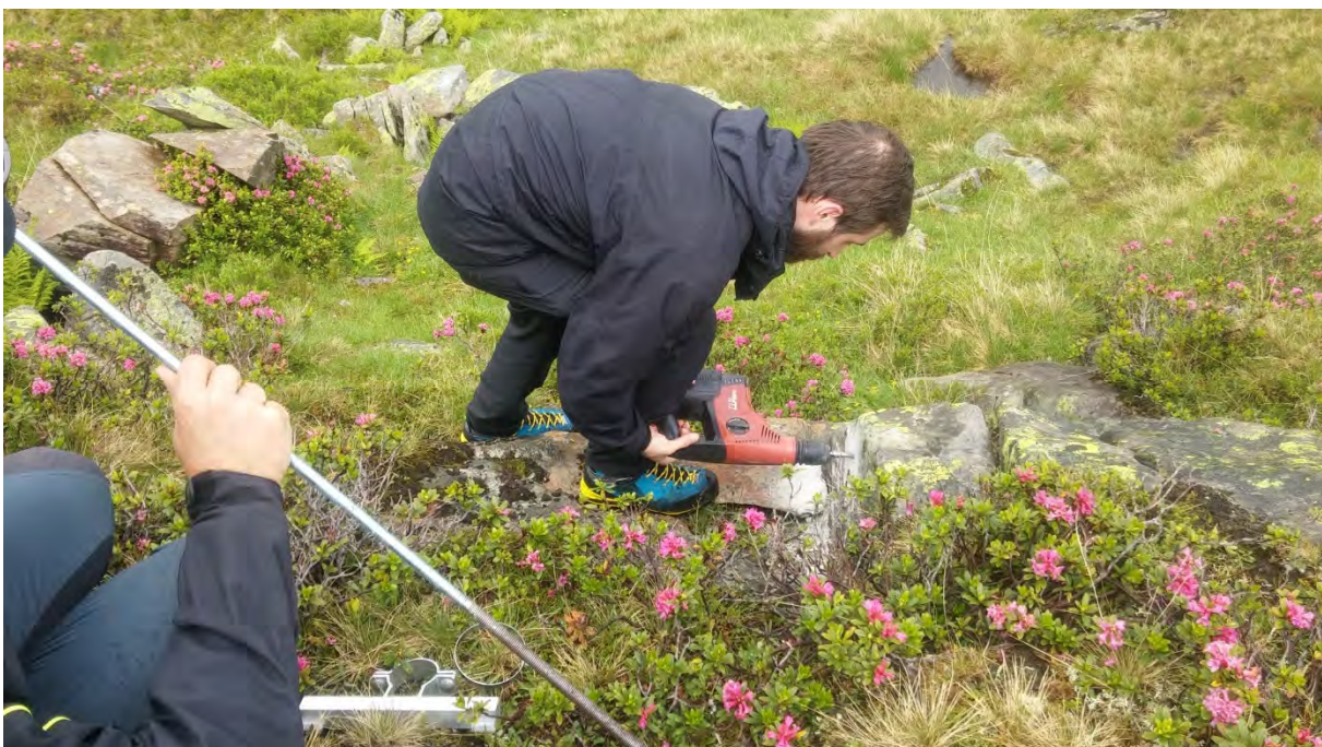
Abbildung 42: Erstellen eines Bohrloches in einem Stein, in welchem die Gewindestange verankert wird; Kamera IN5
