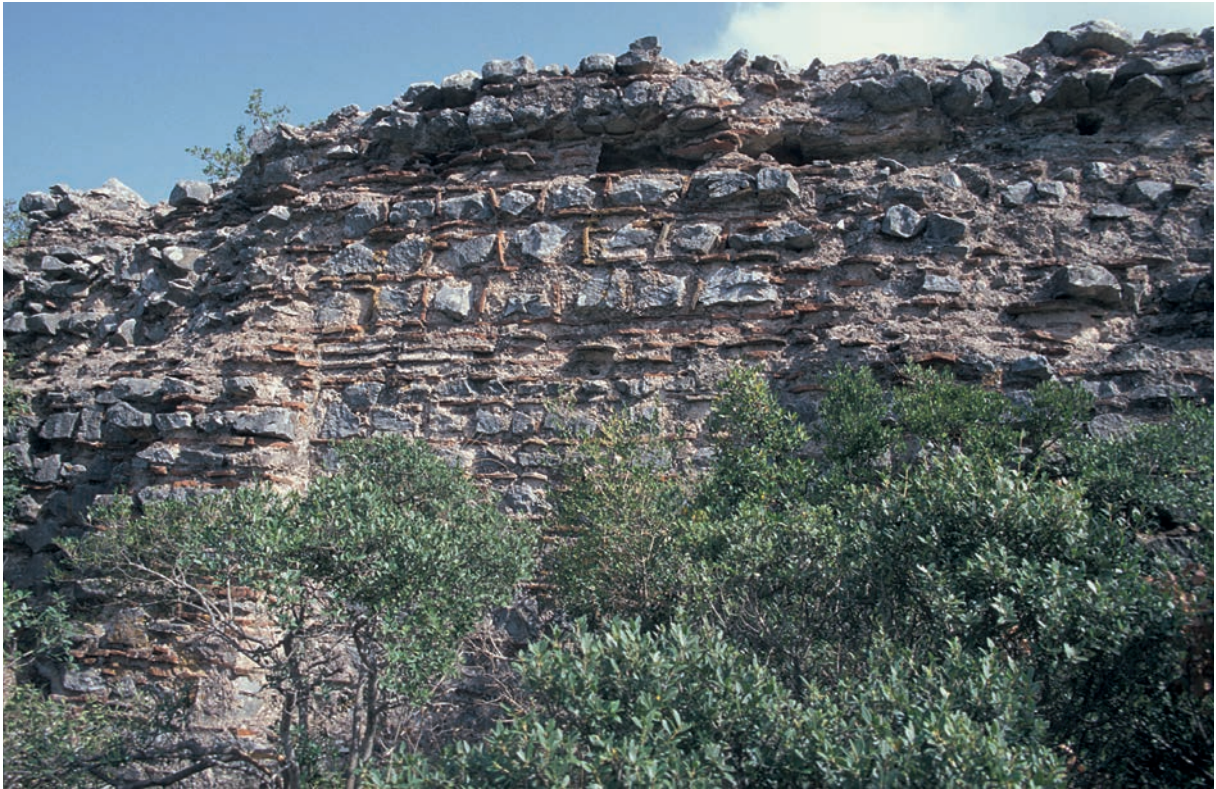
115 Kayapa, Zisterne von außen
